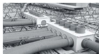
Strop w stanie surowym z przewodami powietrznymi
